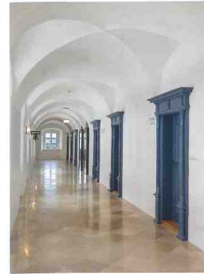
Abb. 11: Nach der Erstellung eines denkmalpflegerischen Türenplans konnten die Türen wieder bauzeitlich geordnet eingebaut werden.
