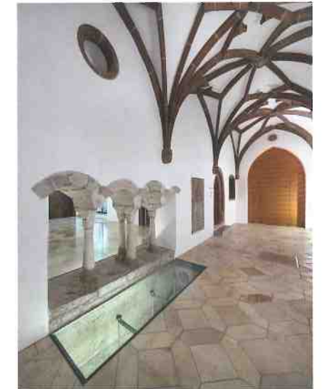
Abb. 4: Die Bodendenkmalpflege fand eine sehr gut erhaltene Wand – die »schöne Wand«. Nach Umplanung konnte sie erhalten werden.
