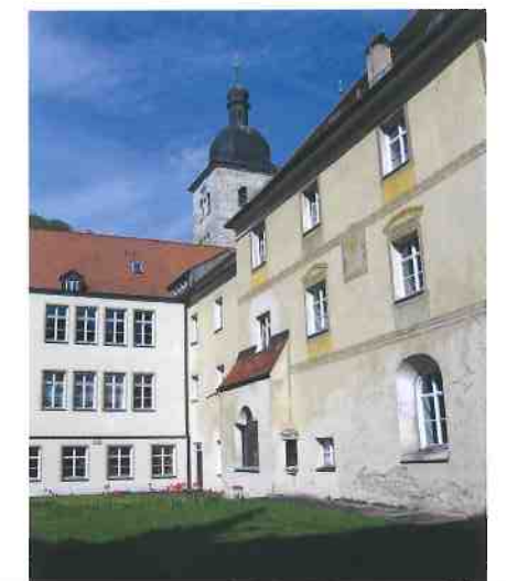
Abb. 5: Schäden an der Fassade durch aufsteigende Feuchte
