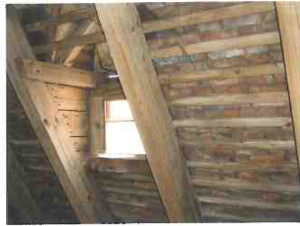
Abb. 21: Für eine bauzeitliche Dachlandschaft wurden die bestehenden Dachgauben wieder der historischen Konstruktion angepasst.
