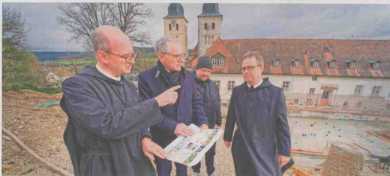
Abt Beda Sonnenberg, Bürgermeister Ludwig Eisenreich, Christian König vom kommunalen Bauamt und Zellerar Frater Andreas Schmidt (von links) haben sich auf der Baustelle umgesehen.
