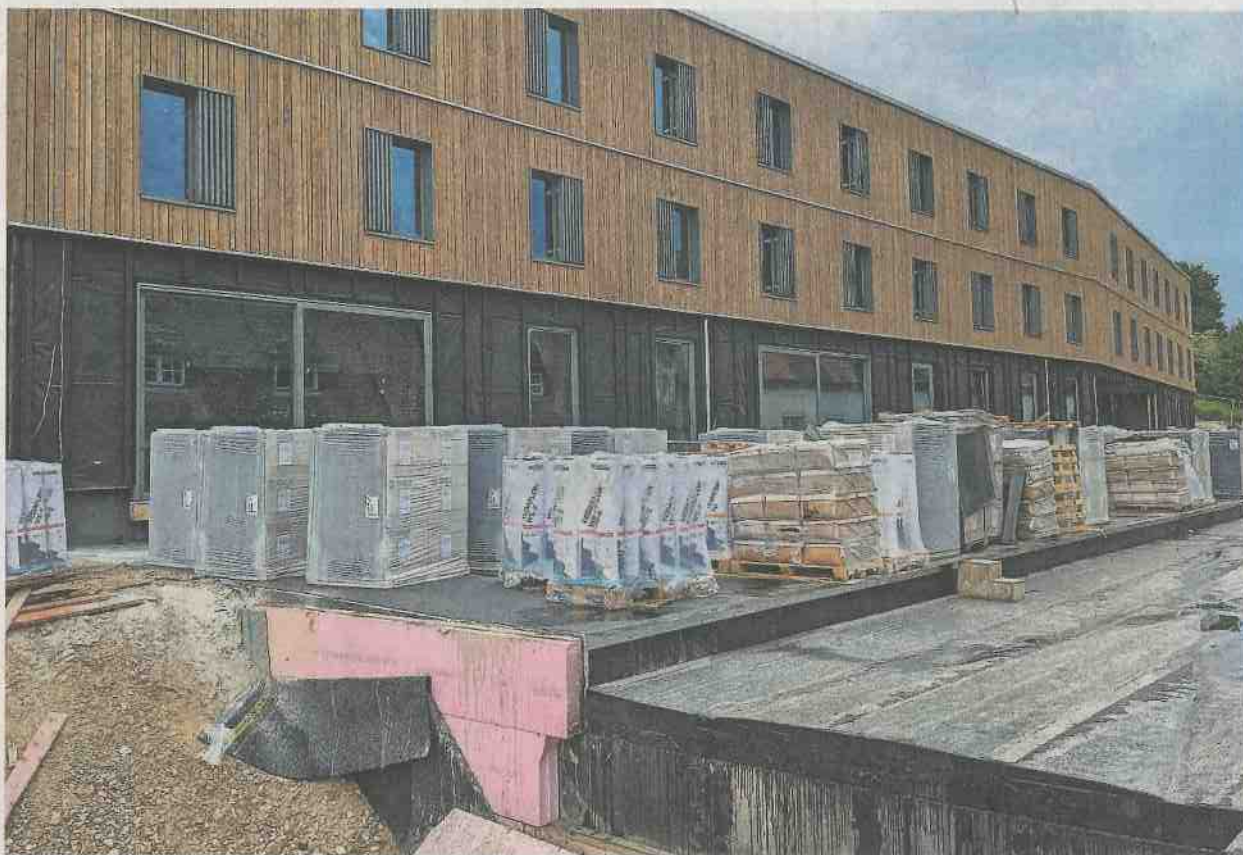
Am Haus St. Wunibald mit Kindergarten wurden vor einigen Tagen das Dach mit Edelstahlblech eingedeckt, die Fassade vertafelt und nun das Gerüst abgebaut.
